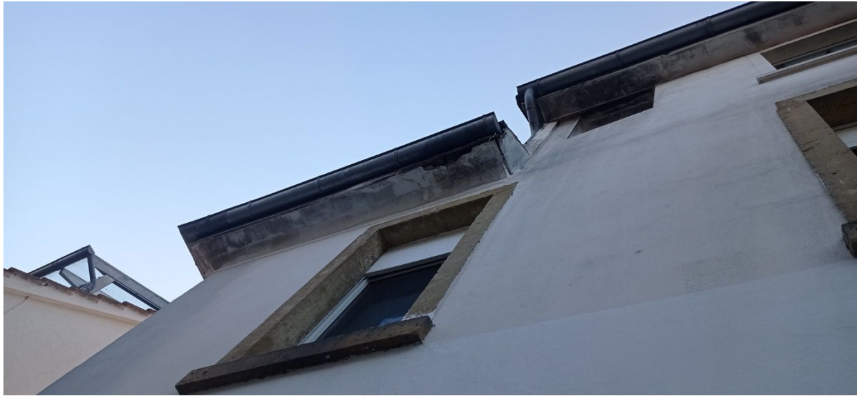
Abbildung 5: Schadstelle am Dachvorsprung mit Hohlraumbildung und dadurch möglicher Niststätte für höhlenbrütende Vögel und Fledermäuse
